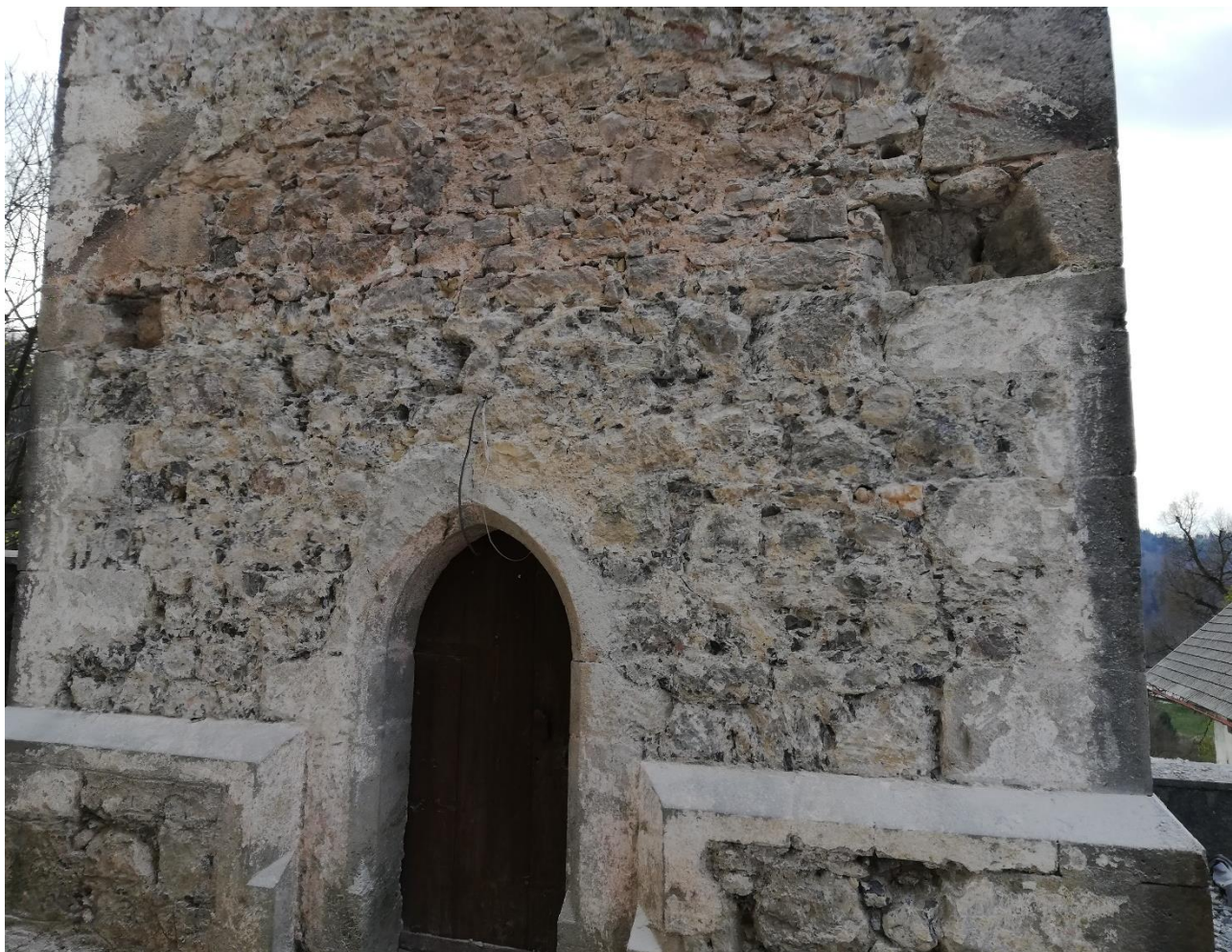
Slika 6: Pogled južno fasado zvonika s sedeži leg za streho.
