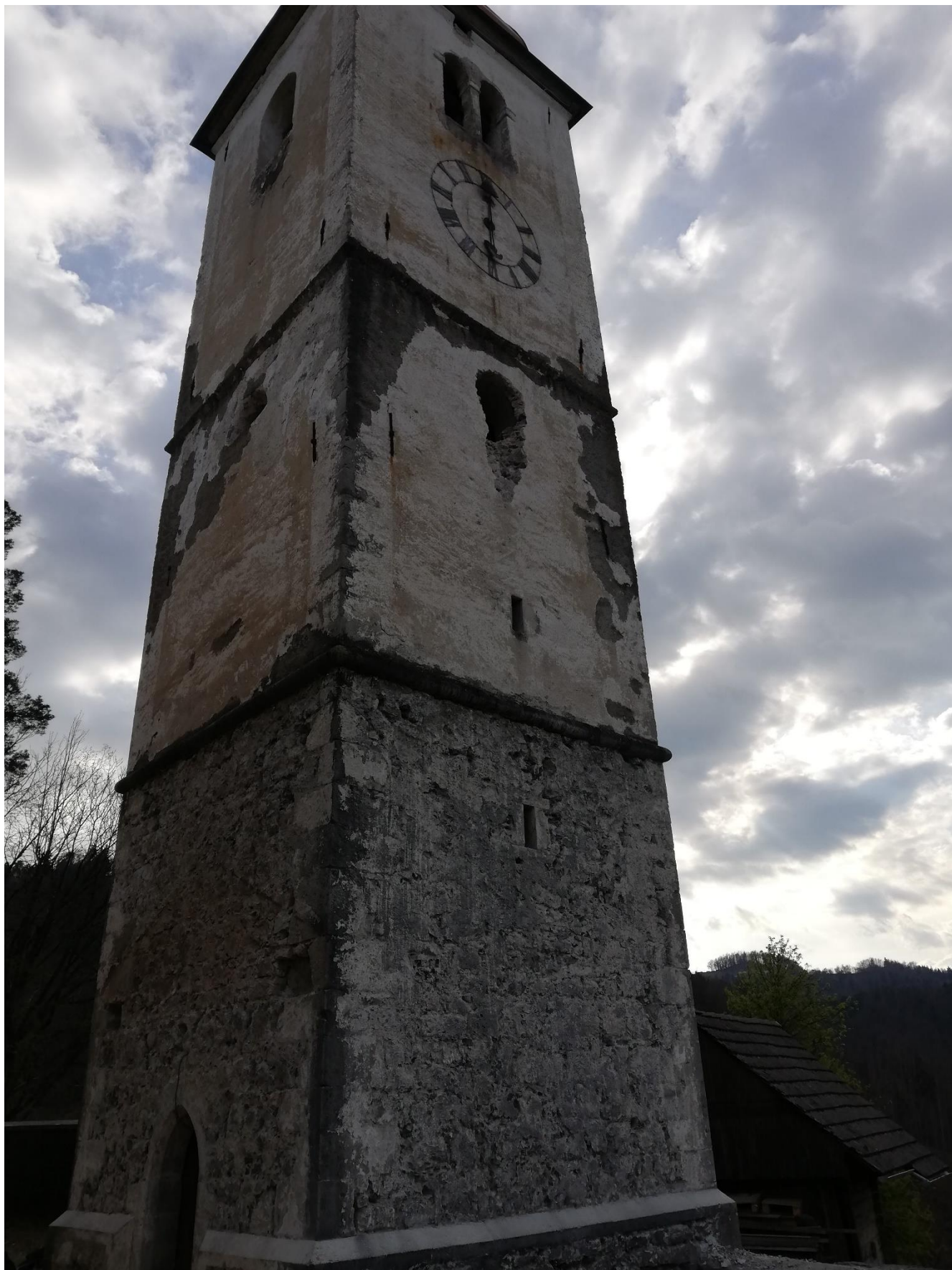
Slika 8: Južna in vzhodna stran zvonika po izvedeni sondaži fasade. Vidni so vogalniki iz kamna in dobro ohranjena zidana struktura kamnitega zidu.
