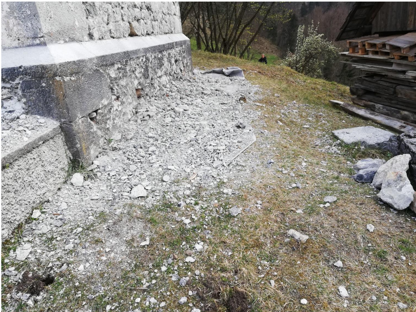
Slika 4: Drenaža zaščiten z filcem in 5 cm nasutjem odstranjene fasade za zaščito filca pred padajočimi kosi.
