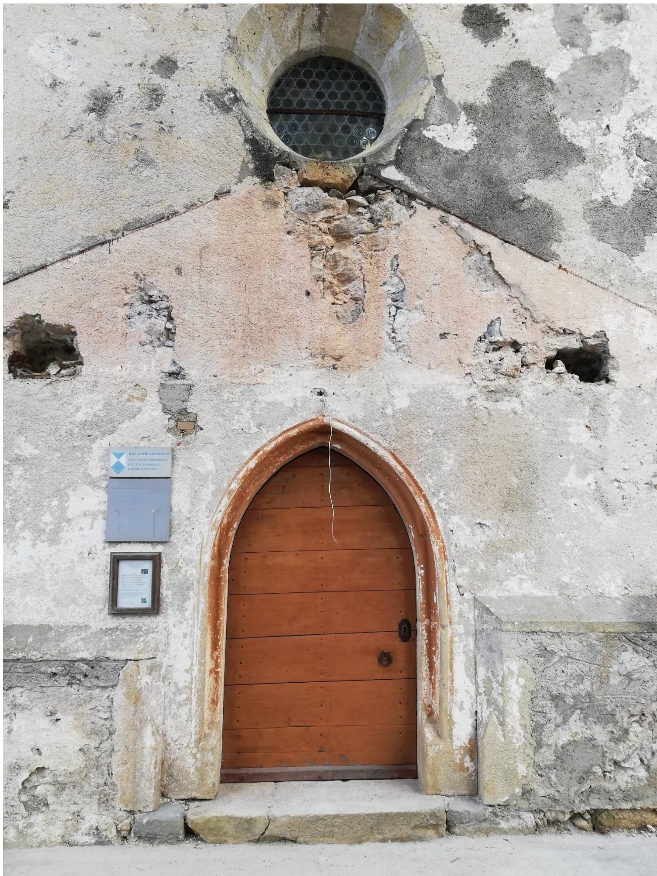
Slika 11: Struktura postavitve spodnjih leg strehe na steni ladje in detajl načete fasade pod oknom, ki je zamakal.
